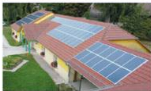
Ecole Saint Euxèry à Foussemagne (90150), 32 000 Wc (Watts-crêtes) mis en service le 13 Nov. 2009
